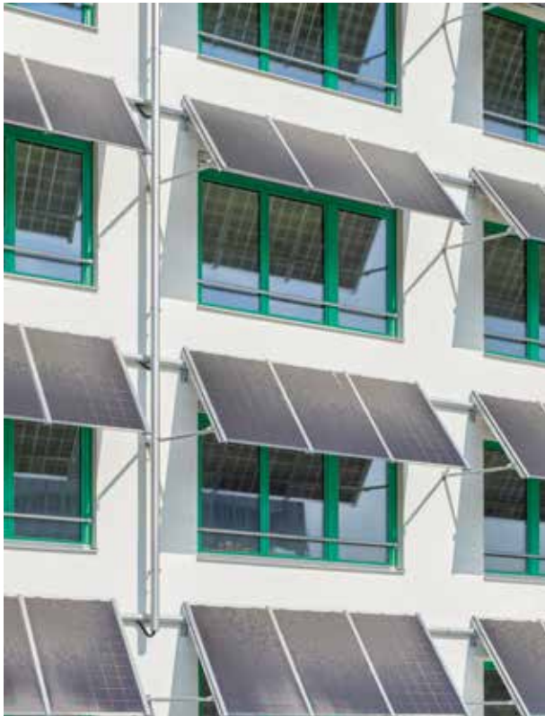
Die Photovoltaik-Anlage prägt die Fassade entscheidend. Die einzelnen Elemente generieren nicht nur Strom, sondern wirken auch als Sonnenschutz. Aufgrund ihrer dominanten Erscheinung eckt der Bau in der Nachbarschaft an.
